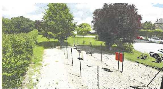
Site de stockage propane Lemé
